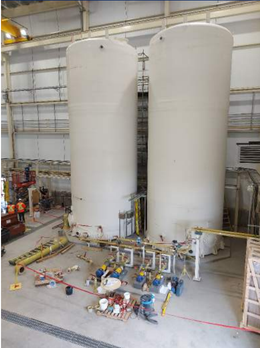
Réservoirs de transfert de saumure - Juin
